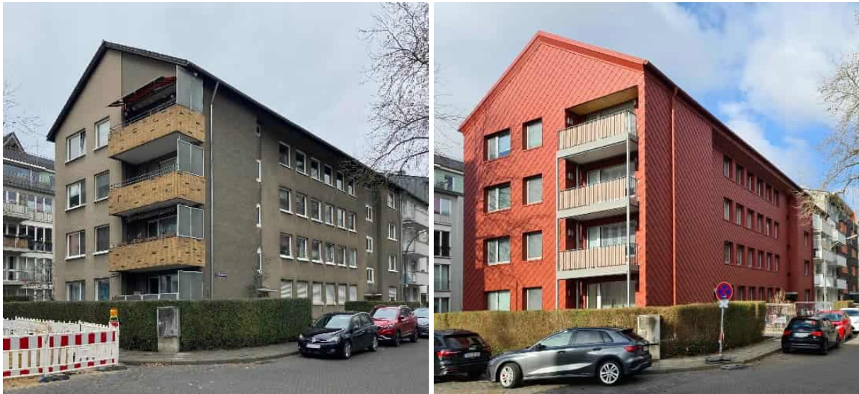
Abbildung 213: Serielle Sanierung Projekt 2426 in Köln vorher – nachher; Planung und Fotos: Zeller Kölmel Architekten, Köln
