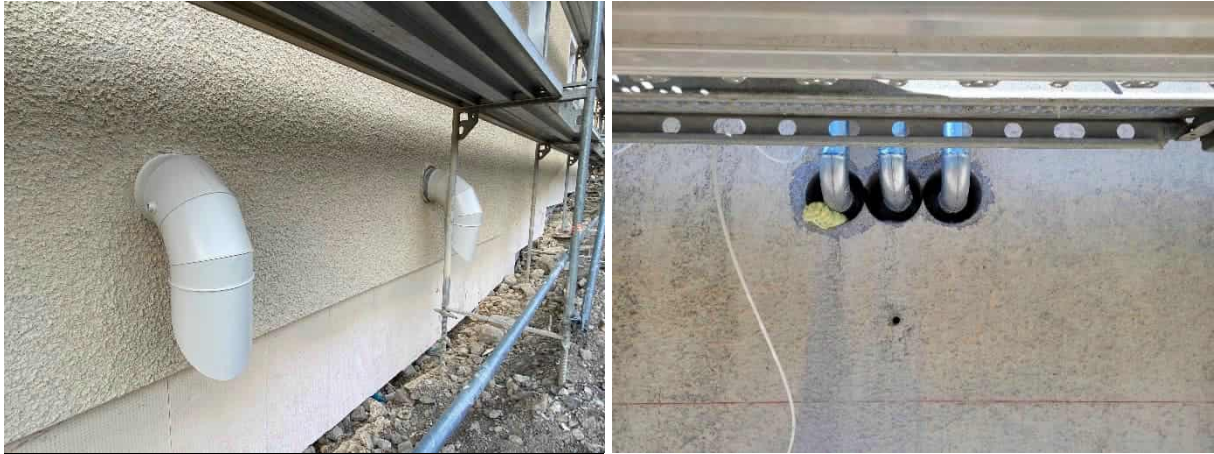
Abbildung 135: Außenluftansaugung und Fortluftausblasung im Sockelbereich; Wanddurchführungen der Zuluftrohre in Höhe Unterkante Kellerdecke; Fotos: Energieinstitut Vorarlberg
