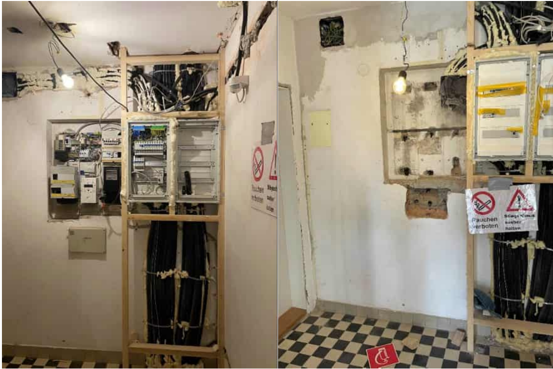
Abbildung 201: Elektroinstallation im Treppenhaus EG; Foto Rhomberg Bau GmbH
