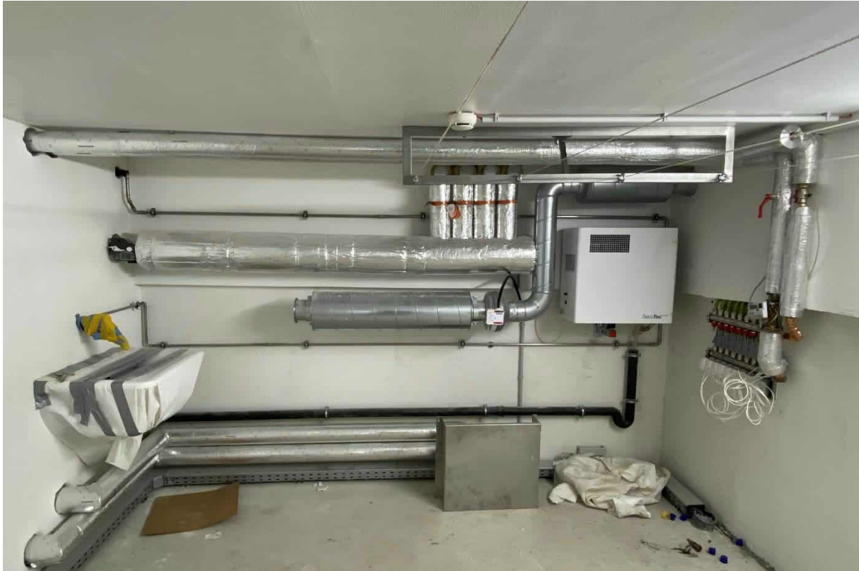
Abbildung 137: Abluftanlage und Raumfeuchter im Trockenraum; Foto: Energieinstitut Vorarlberg
