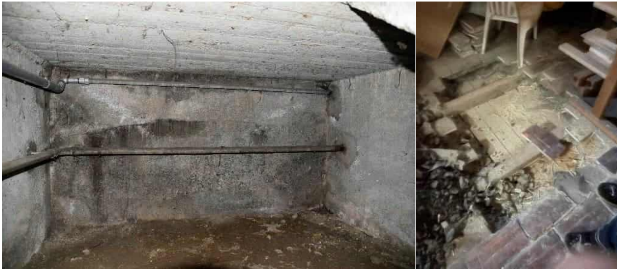
Abbildung 4: Zustand des Kellers im großen Gebäude (links) und oberste Geschoßdecke im kleinen Gebäude; Fotos Rhomberg Bau GmbH
