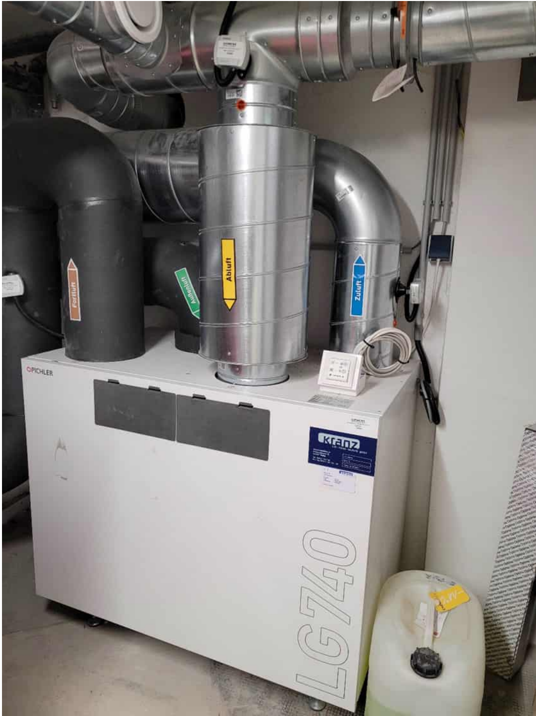
Abbildung 194: zentrales Komfortlüftungsgerät mit Wärmerückgewinnung im kleinen Gebäude; Energieinstitut Vorarlberg
