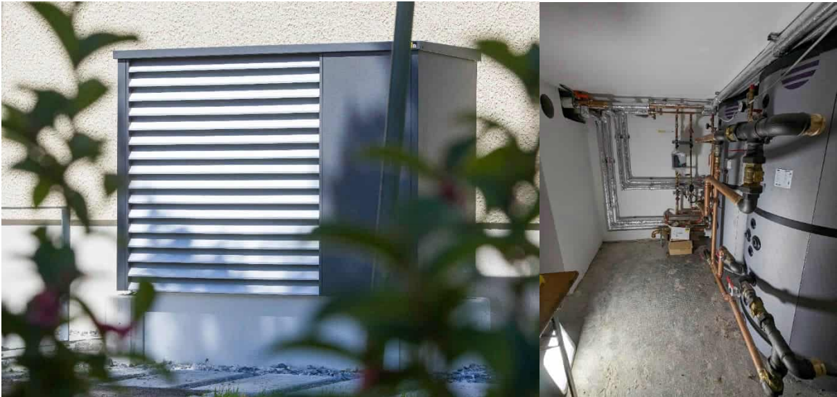
Abbildung 12: Luftwärmepumpe und Schichtspeicher großes Gebäude; Fotos: Walser Fotografie, Hohenems, links, Johannes Kaufmann und Partner GmbH, rechts
