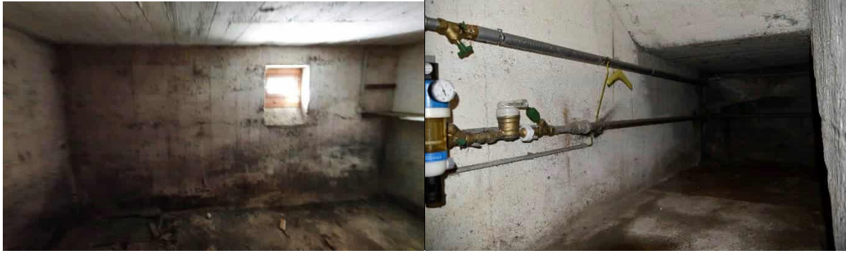
Abbildung 40: Kellergeschoss im kleinen Gebäude – links und im großen Gebäude, Fotos: Rhomberg Bau GmbH Bau GmbH
