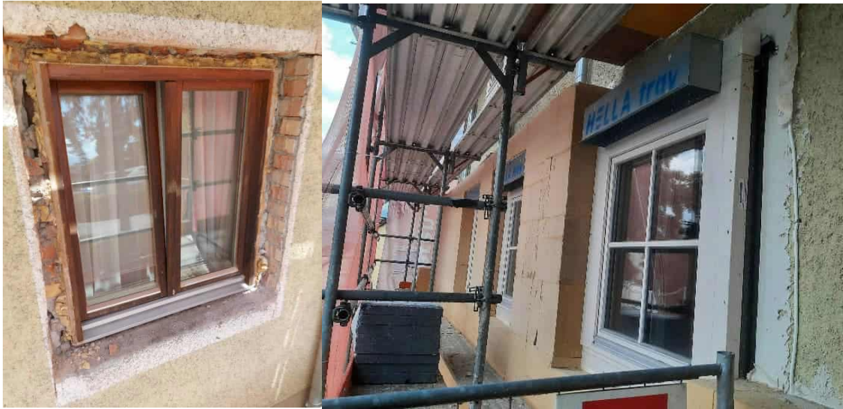
Abbildung 162: kleines Gebäude: Demontage der Fenster; Foto Rhomberg Bau GmbH; Fenster und Jalousiekästen; Foto: Energieinstitut Vorarlberg
