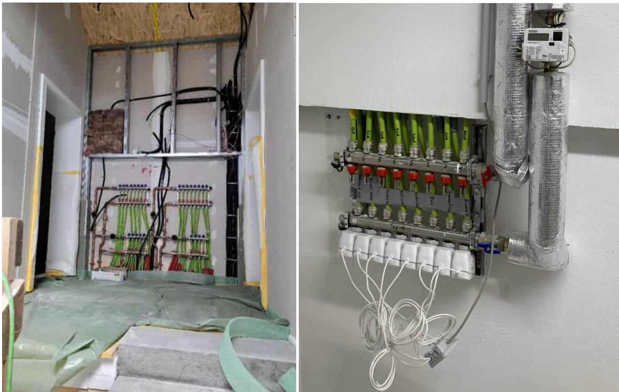
Abbildung 128: Außenwandheizungs-Heizkreisverteiler im Treppenhaus DG (links), Foto: Rhomberg Bau GmbH und im Kellergeschoß, Foto: Energieinstitut Vorarlberg
