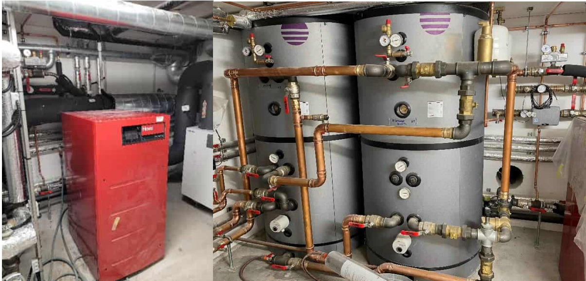
Abbildung 185: Erdreich-Wärmepumpe und Pufferspeicher 2 * 820 Liter im kleineren Gebäudes; Foto: Energieinstitut Vorarlberg
