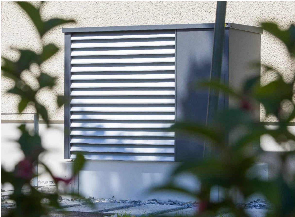
Abbildung 125: Luft-Wärmepumpe des großen Gebäudes; Foto: Walser Fotografie, Hohenems
