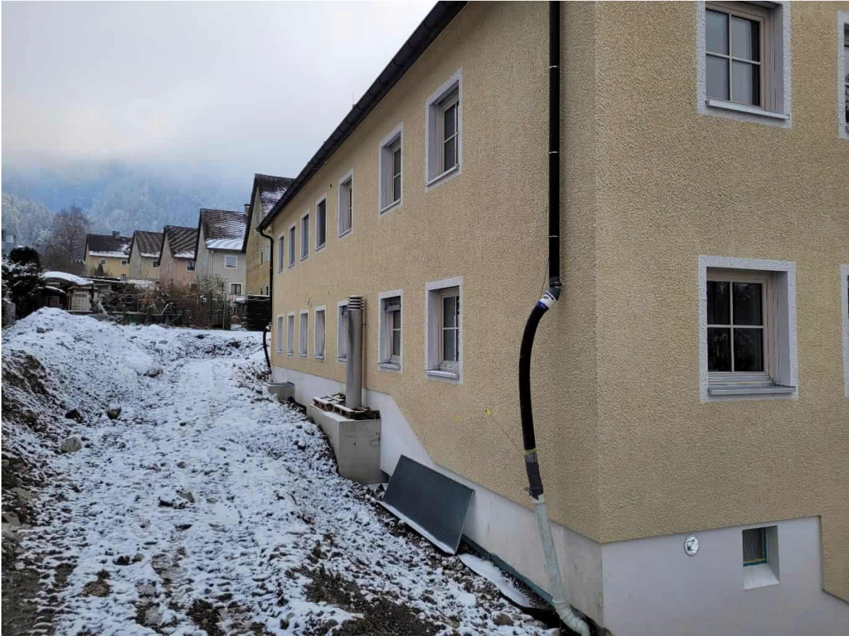
Abbildung 196: Außenluftansaugung an der Rückseite des Gebäudes; Energieinstitut Vorarlberg
