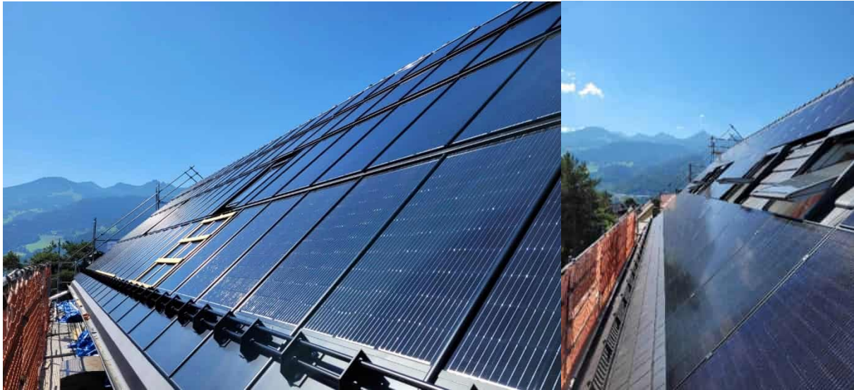
Abbildung 13: dachintegrierte PV-Anlage im großen Gebäude und Aufdachanlage im kleinen Gebäude; Fotos: Energieinstitut Vorarlberg
