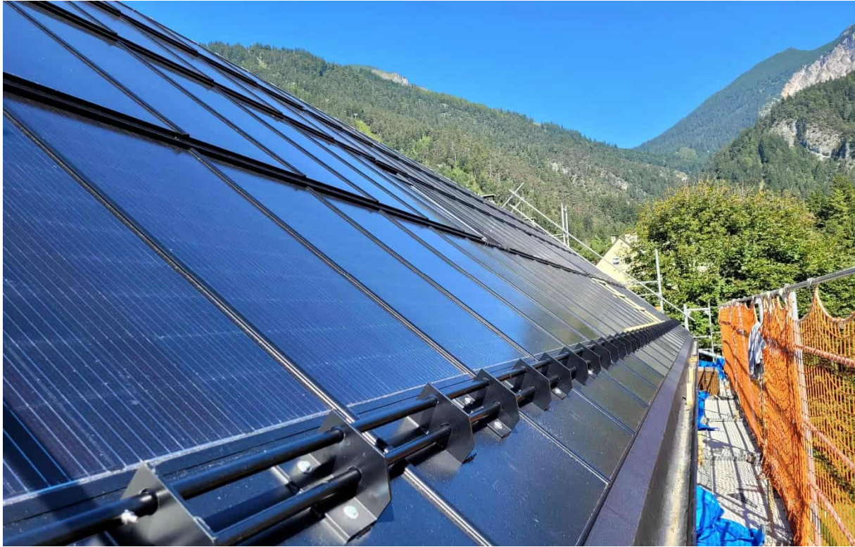
Abbildung 139: Indach-PV-Anlage im großen Gebäude; Foto: Energieinstitut Vorarlberg
