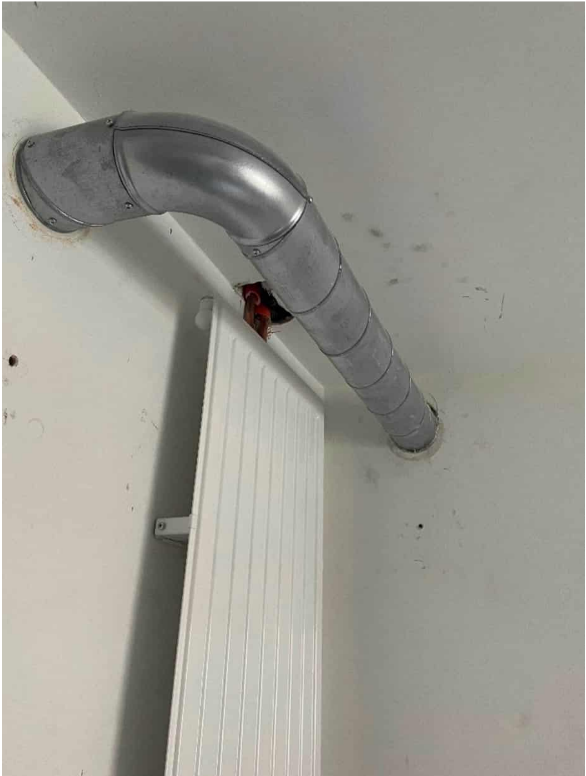
Abbildung 189: Niedertemperatur-Heizkörper und Lüftungsleitung in einer Bestandswohnung im kleinen Gebäude; Energieinstitut Vorarlberg
