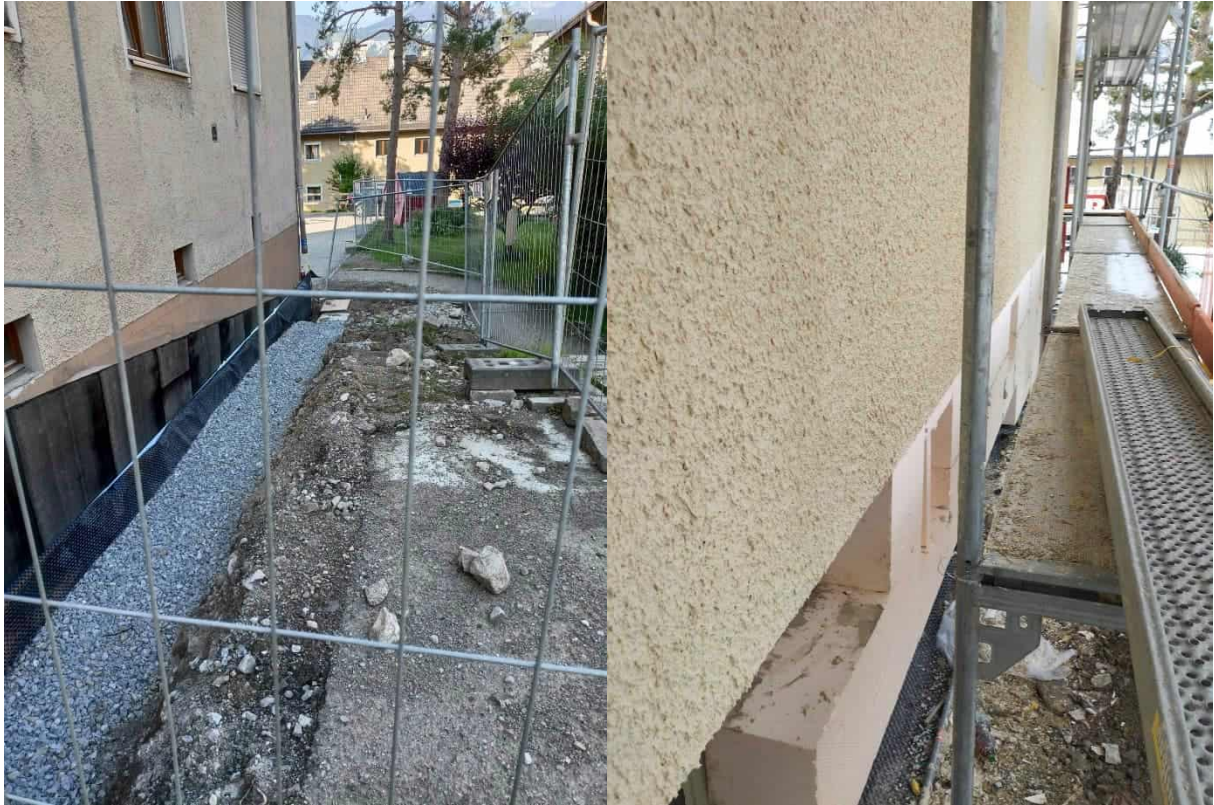
Abbildung 99: Verfüllung mit Schotter; verstärkte Dämmung im Sockelbereich – großes Gebäude; Fotos: Rhomberg Bau GmbH
