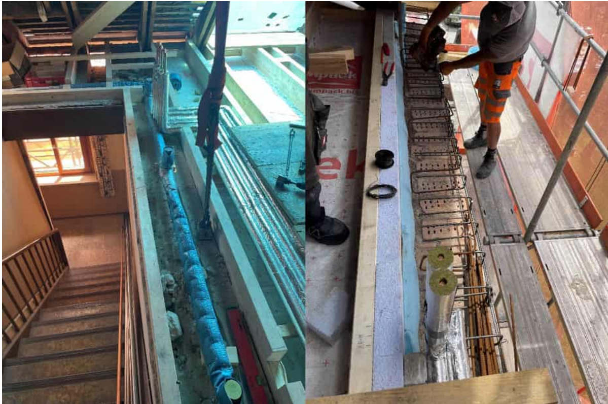
Abbildung 173: kleines Gebäude: oberste Geschoßdecke vor Schließen des Treppenhauses; giebelseitiger Anschluss an Bestands-Außenwand, Fotos: Rhomberg Bau GmbH
