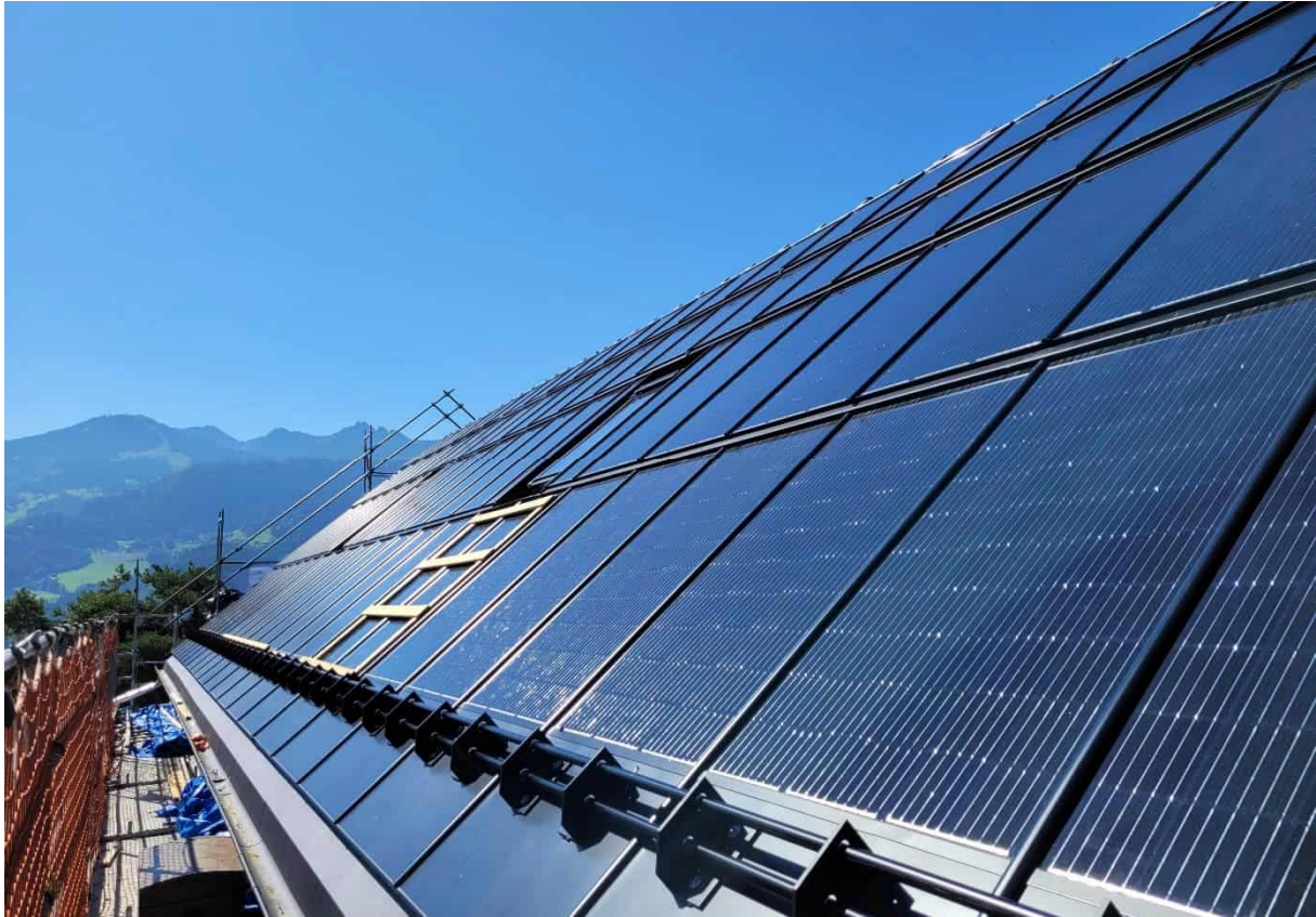
Abbildung 138: Indach-PV-Anlage im großen Gebäude; Foto: Energieinstitut Vorarlberg
