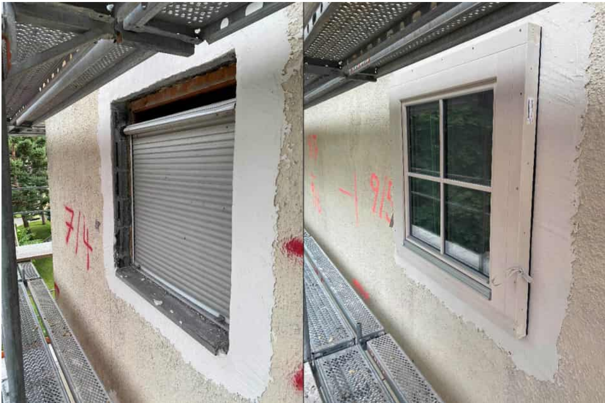
Abbildung 116: Glattstrich als Grundlage für das Verkleben der Fenster in der Dämmebene; eingebautes Fenster mit Holzrahmen und Wiener Sprosse; Foto: Rhomberg Bau GmbH
