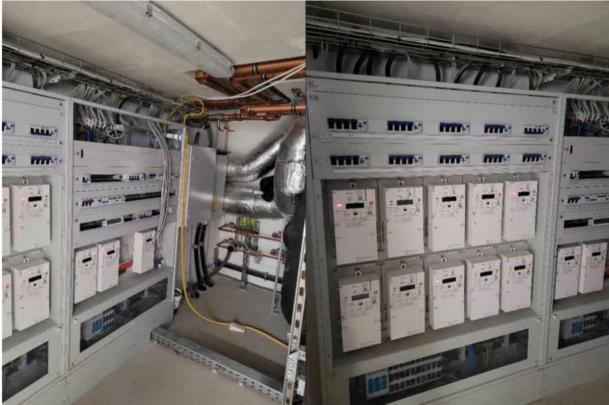
Abbildung 141: Elektrozähler im Kellergeschoß; Fotos: Energieinstitut Vorarlberg
