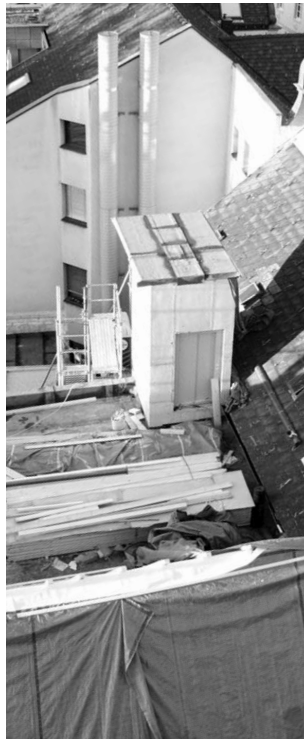
In der Innenstadt ist Platz oft sehr beschränkt – so auch bei der Baustelleneinrichtung.
