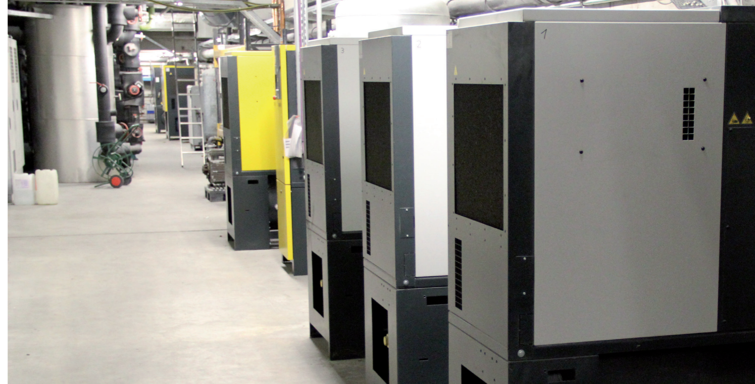
Das Herzstück der neuen Druckluftsteuerung: Der Technikraum mit mehreren Kompressoren.
