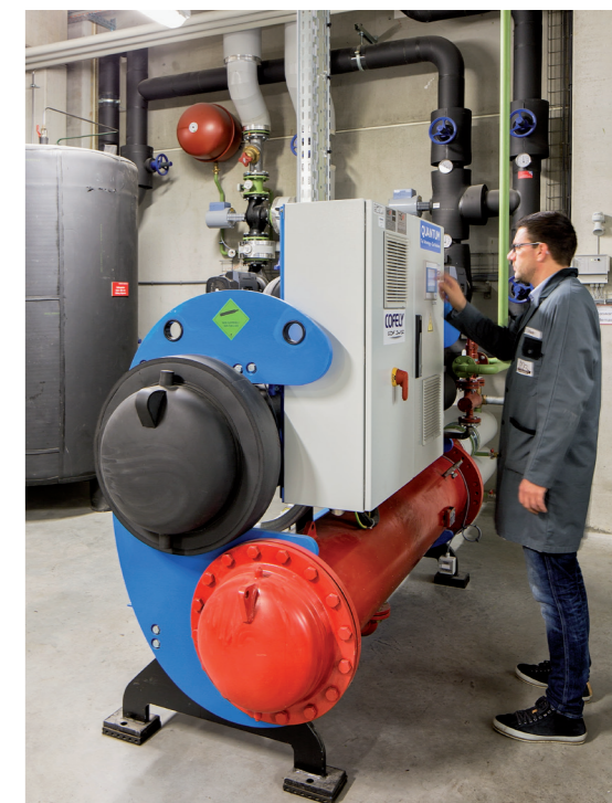
Die Nutzung der Abwärme der Kältemaschinen ist Teil des Energie-Konzepts.
