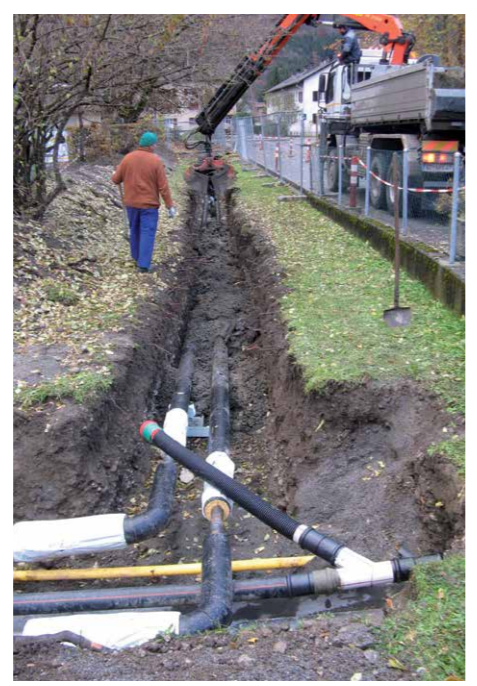
Über eine rund 900 Meter lange Leitungstrasse werden die externen Abnehmer mit Fernwärme versorgt.
