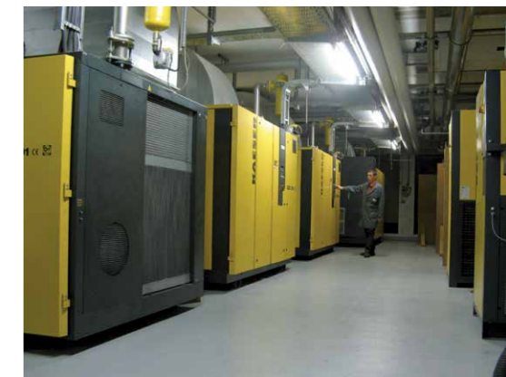
72 Prozent des Stromverbrauchs der Kompressoren werden als Wärme zurück gewonnen.
