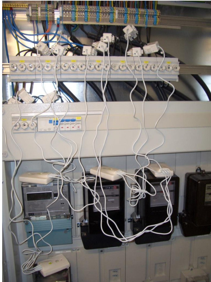
Abbildung 5: Zähleraufbau (oben: Ringkernsensoren zur Erfassung der Stromstärke; unten: Funktransmitter für Datenübertragung an Empfangseinheiten)
