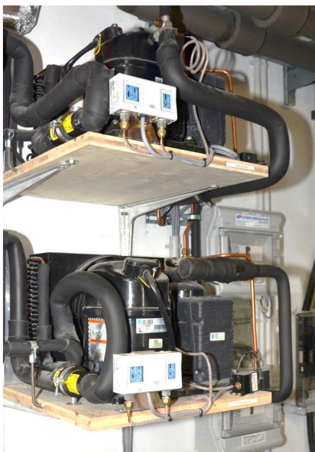
Abbildung 9: Zwei Kältemaschinen für Versorgung der Kühlmöbel (oben: Tiefkühlung; unten: Pluskühlung)
