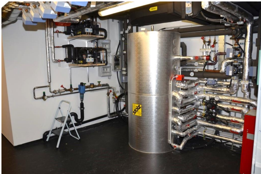
Abbildung 2: Überblick Haustechnikraum (links: Kälteaggregate; Mitte: Pufferspeicher; rechts: Wärmepumpe (rot))
