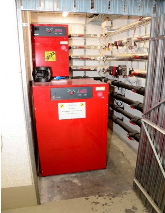
Abbildung 13: Wärmepumpe HT (WW) oben und Wärmepumpe NT (Heizung) unten.
