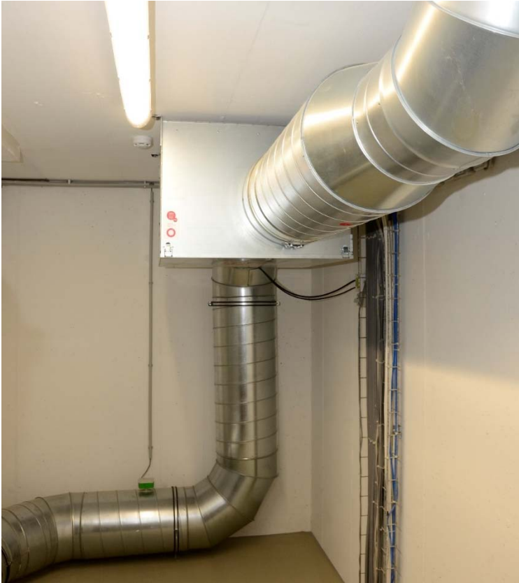
Abbildung 19: Zentraler Abluftventilator im Technikraum im 2.OG.
