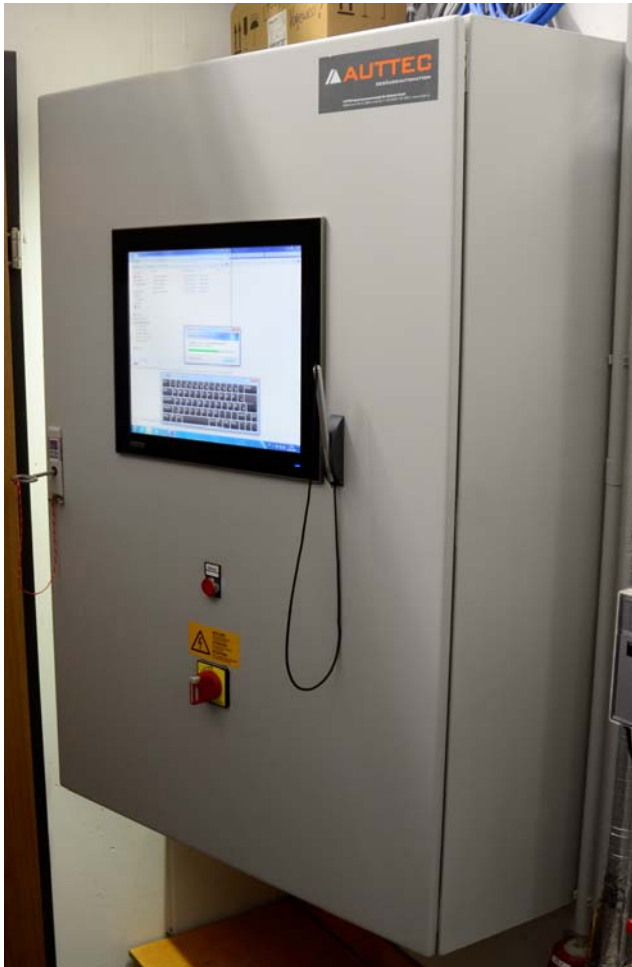
Abbildung 24: Zentraler Leit- und Monitoring-Panel-PC.
