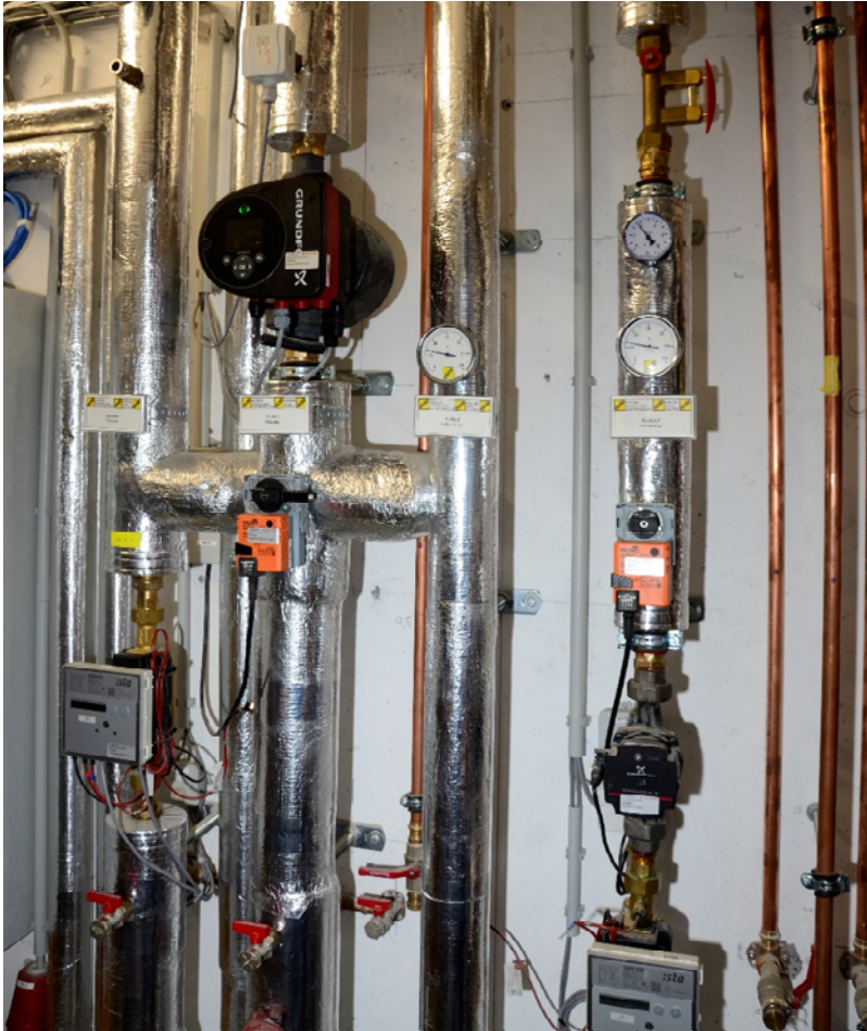
Abbildung 16: Heizkreispumpe (oben links) und Solarpumpe (unten rechts).
