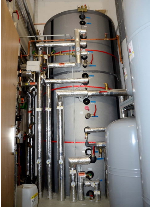
Abbildung 11: Speicher für Heizung und Warmwasser.
