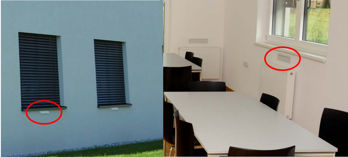
Abbildung 21: Nachströmöffnungen (links Außenansicht, rechts Innenansicht).
